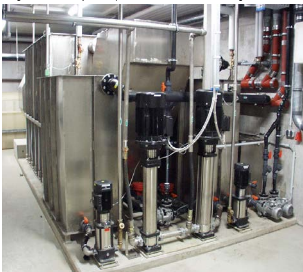
BioClassic bovengrondse installatie
